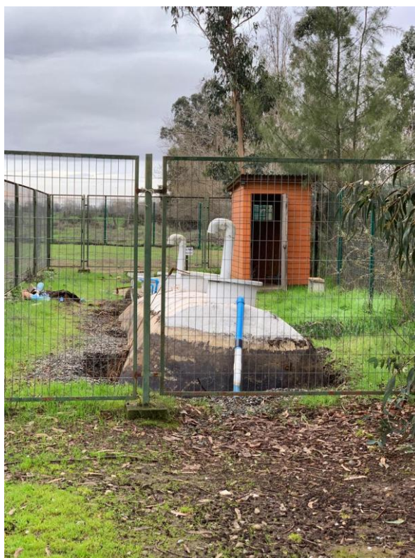
Imagen Planta de Tratamiento de Aguas Servidas de la Escuela Pangue Arriba, situación a subsanar por el proyecto de Conservación Emergencia Escuela Pangue Arriba
